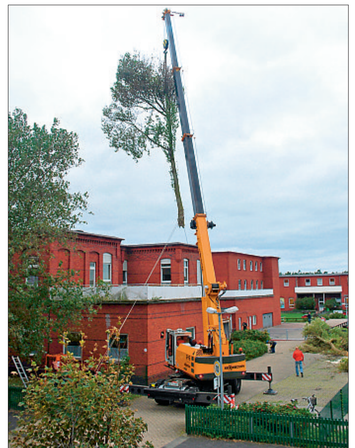
Auf dem Gelände des Seehospizes Norderney mussten gestern drei abgängige Pappeln weichen. Wie Geschäftsführer Karlheinz van Heuveln berichtete, seien bei dem großen Sturm vor einigen Wochen bereits große Äste von den morschen Bäumen heruntergekommen. Da die Pappeln an der Hauptzuwegung zum Kindergarten stehen, wollte man das Risiko für Kinder und Eltern unbedingt eindämmen. Ob die Stelle neu bepflanzt wird, konnte van Heuveln noch nicht absehen. FOTO: VISSER
